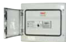
Coffret de commande 0049-04
